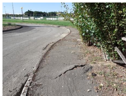
Cesa in Valdichiana: scarsa manutenzione del marciapiede che corre lungo il giardino ad uso pubblico di via Ugo Foscolo
