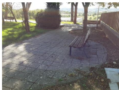
Marciano della Chiana: avvallamento nel percorso interno del giardino pubblico di via Vittorio Veneto
