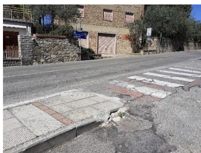
Ufficio Postale di Lucignano: scarsa manutenzione del marciapiede che ne consente l’avvicinamento dal parcheggio
